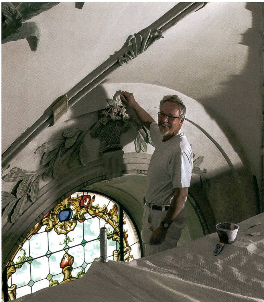
Trotz des insgesamt guten Zustandes des Gewölbes fehlten da und dort kleinere Stuckteile. Viktor Wicky, Stuckateur der Firma Knöchel und Pungitore, ersetzt ein fehlendes Blatt. (Abb. 6)
