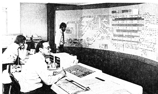
Der Badische Bahnhof in Basel erhielt kürzlich eines der modernsten Stellwerke der Deutschen Bundesbahn. Es ersetzt neun mechanische Stellwerke mit einem Alter von zum Teil über sechzig Jahren. Während bisher dreizehn Bedienungskräfte nötig waren, genügen jetzt vier, um die Zug- und Rangierfahrten zu steuern und zu überwachen. Innerhalb von 24 Stunden rollen im Schnitt 410 Züge durch den Bahnhof, neben denen rund 1500 Rangierfahrten zu bewältigen sind. Neben erhöhter Sicherheit bringt das Spurplanstellwerk, das 24 Millionen Mark gekostet und vier Jahre Bauzeit erforderte hat, auch eine spürbare Beschleunigung des Zugverkehrs an dieser wichtigen Nahtstelle des europäischen Eisenbahnverkehrs. Der Badische Bahnhof in Basel liegt auf Schweizer Hoheitsgebiet, wird aber von der Deutschen Bundesbahn betrieben.
