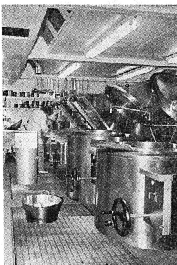
3 Produktionsteil der Warmen Küche im Hotel Nova Park Zürich. Gleich rechts hinter der Kesselgruppe die halbhohle Trennwand zur Fertigung.
