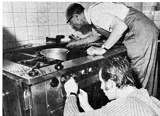
Les problèmes de l'énergie sont aussi ceux de l'hôtelier et du restaurateur modernes: choix, utilisation rationnelle et économique, programmation. Ici, la transformation d'un fourneau de grande cuisine pour le gaz naturel. (USOGAZ)
