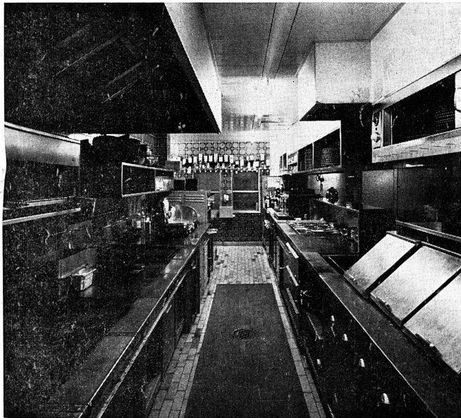
Alpha-Palmiers: Vue de la cuisine de service que peuvent aussi contempler les clients; on y remarque la table chaude, les grills, la trancheuse à viande et le système de doseurs automatiques des boissons.
