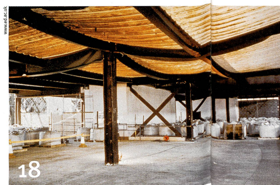
La chaleur ramollit les charpentes en acier. Des chercheurs tentent de les rendre plus résistantes en cas d'incendie.
