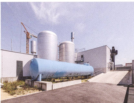
Der Inhalt des blauen Öltanks kommt nur noch bei Spitzenlasten zum Einsatz.
