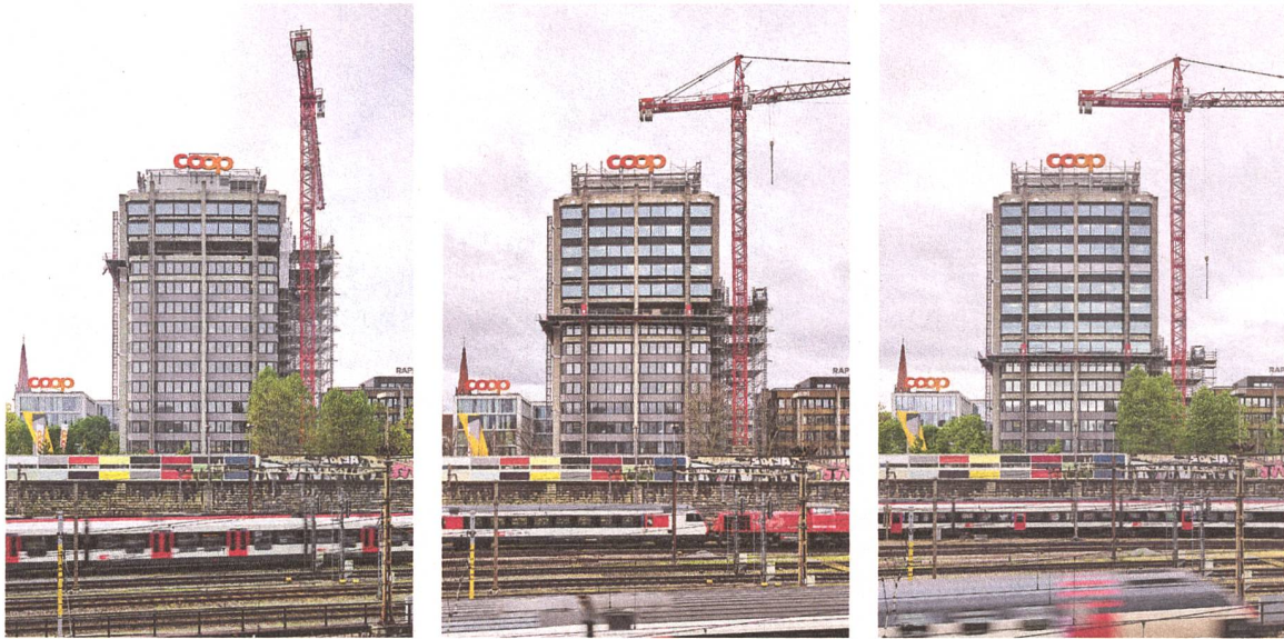
Bei der Sanierung des Coop-Hauptsitzes von 1978 konnte man den Wechsel der Fassade von oben nach unten schön verfolgen. Fotos: Mark Niedermann
