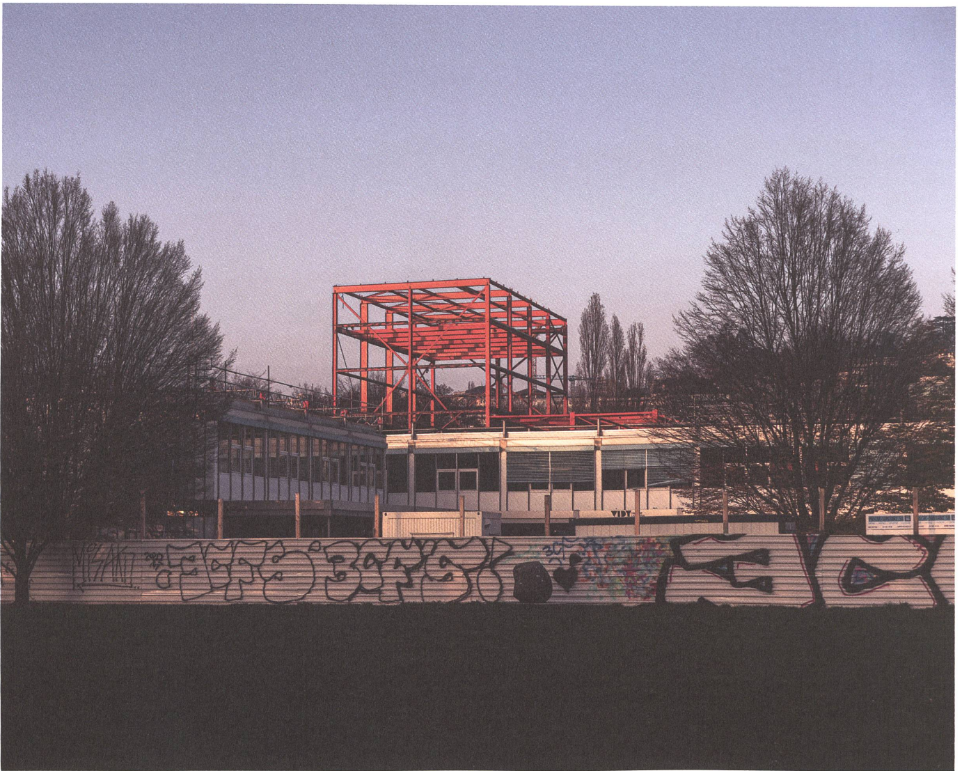
Die Stahlstruktur des Theaters ist eins der wenigen Fragmente, die noch aus der Bauzeit unter Max Bill stammen.
