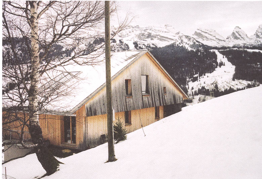
Die Schalung am Abwurfdach an der Nordfassade vergraut zusehends.
