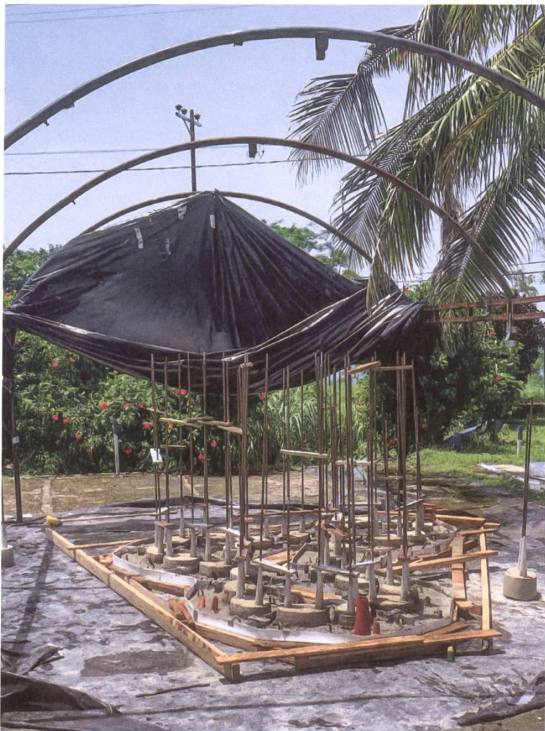
Improvisierte Gussformen zur Herstellung der Betonplattformen, die als Fundamente des Kunstriffs dienen.
