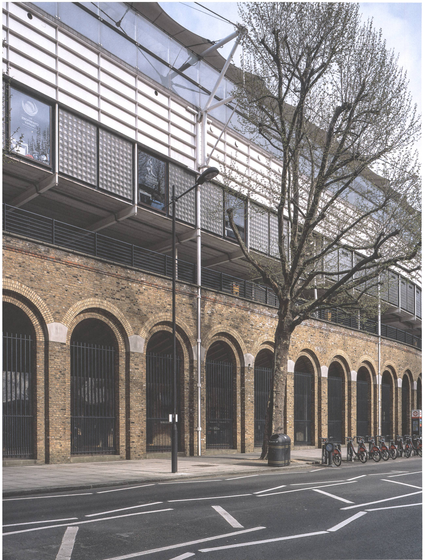
Sportfeld Lord's Cricket Ground, Abschnitt Mound Stand (1984–1987): Nicht nur der obere Teil stammt von Michael Hopkins Architects, sondern auch die gemauerten Bögen.
