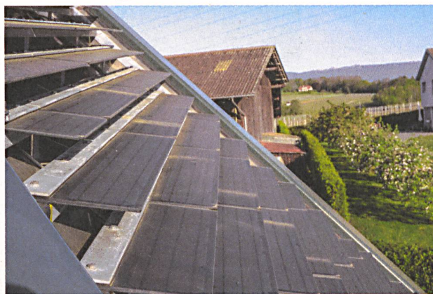
Eine einfache Klemmkonstruktion hält die Photovoltaik-Module. Fotos: Vincent Mermod
