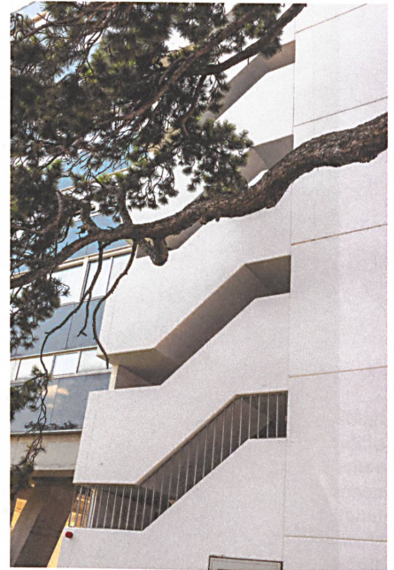
Flacheisen binden den in die Ostfassade geschobenen Treppenturm nun erdbensicher an die Tragstruktur.
