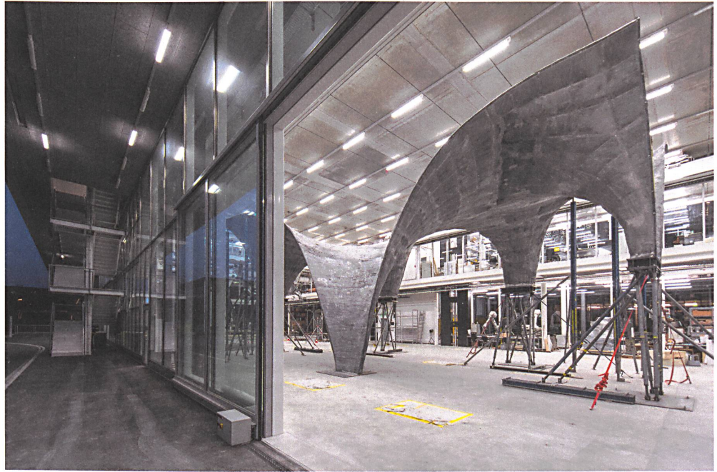
Hängend betonieren: Für das «Nest»-Gebäude der Empa in Dübendorf bauten die Forscher einen Prototyp, für dessen Dach sie ein Stahlseilnetz mit einem Gewebe spannten und als hängende Schalung nutzten. Fotos: Naida Iljazovic, Michael Lyrenmann
