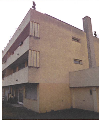
Die Fassade vor der Sanierung...
