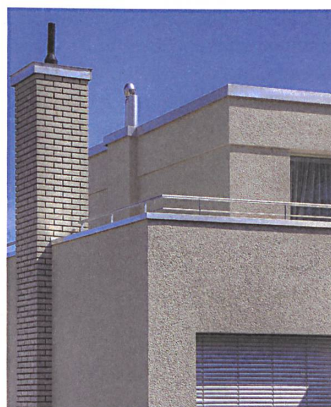
Die neue Kompaktfassade verleiht dem Haus aus den Sechzigerjahren ein zeitgemässes Erscheinungsbild.
