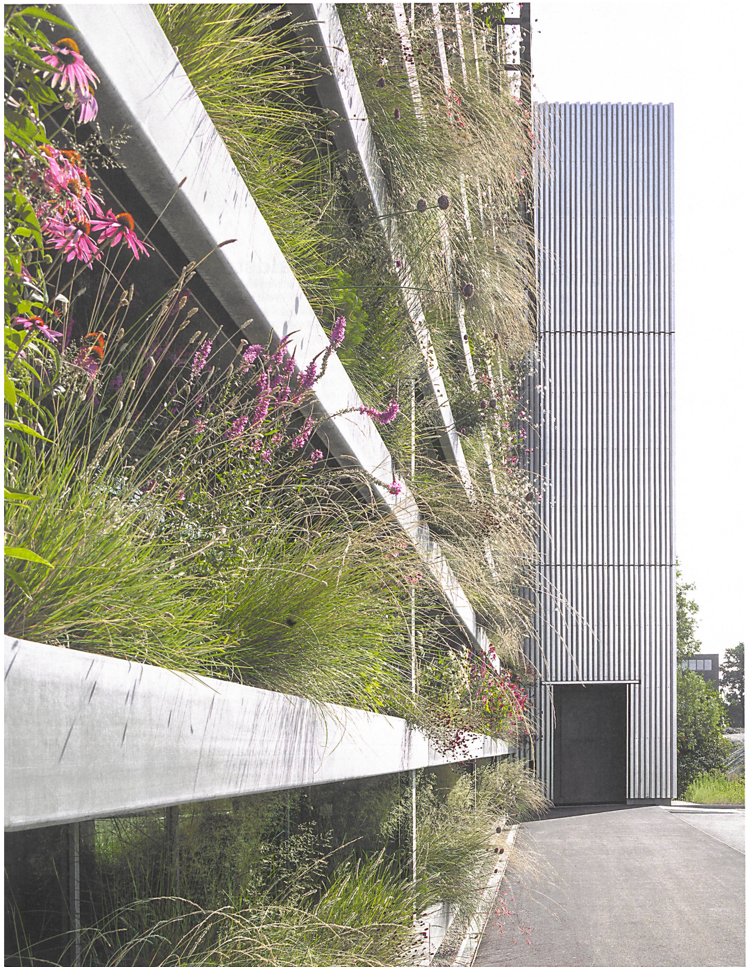
Die Fassade des Skyframe-Gebäudes in Frauenfeld ist auch im dritten Jahr nach dem Bau noch grün – dank kluger Konstruktion, Pflanzenwahl und Pflege. Foto: Claudia Luperto
