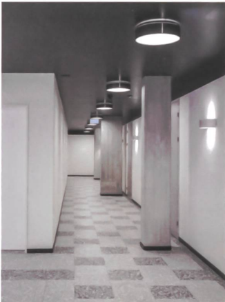
In den Korridoren sind die Unregelmässigkeiten der Statik ablesbar.
