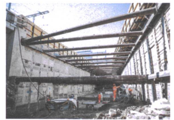
Bauphase 2: Aufwendige Verstrebungen halten beim künftigen Zugang Andreasstrasse die Bahndämme an ihrem Ort.
