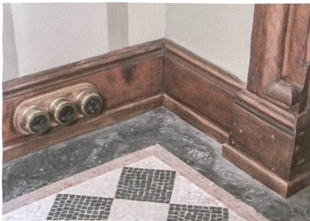
6 Die Einsätze für die Aufputzmontage mussten neu hergestellt werden. Sie integrieren auch USB-Anschlüsse.
