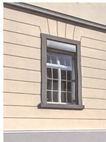
Flächige Glasscheiben vor den Fenstern statt Gitter.
