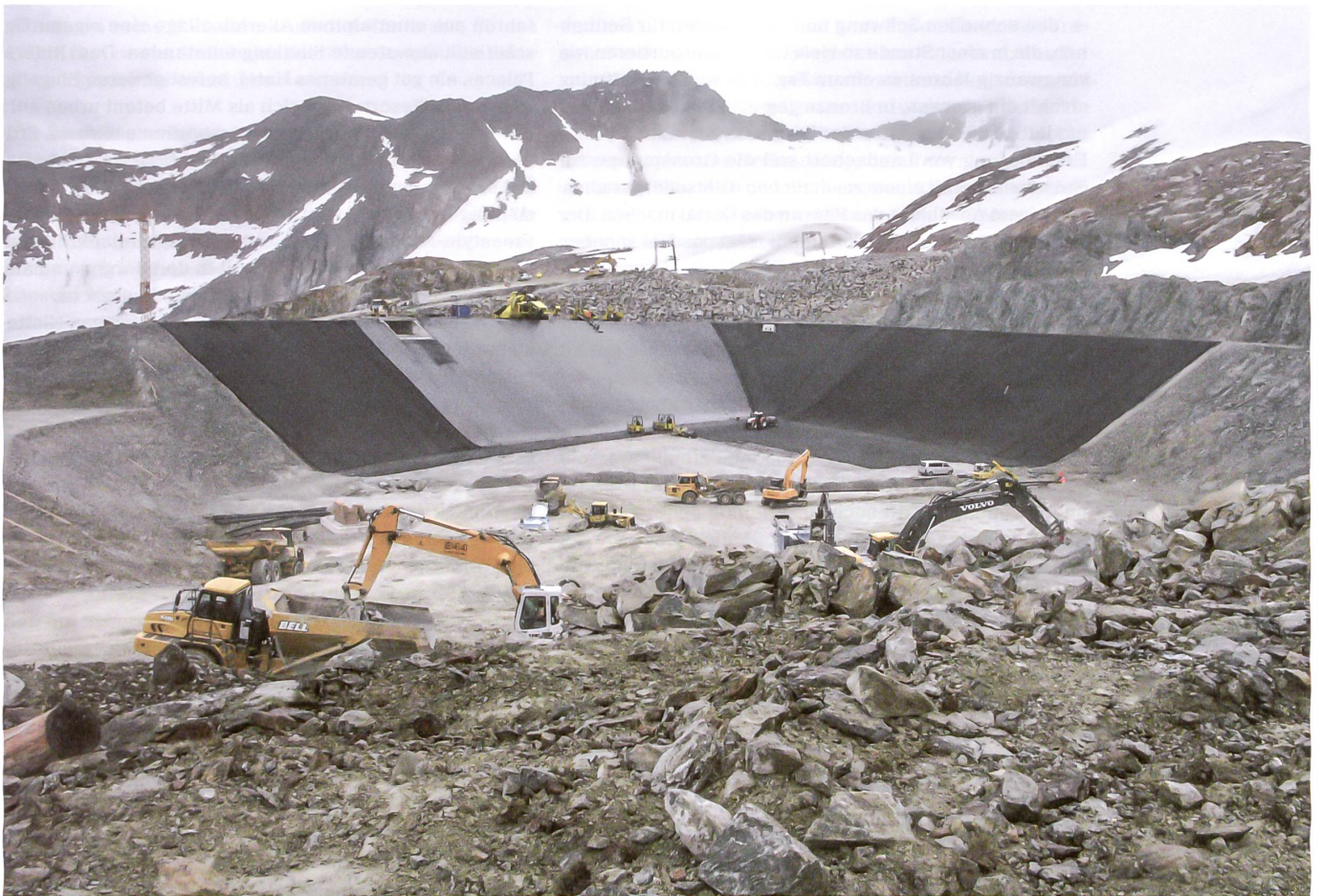
Schwerer Tiefbau für das Wasser der Schneekanonen: Bagger stellen im Sommer die Landschaften für die Fremdenindustrie von Sölden her. Foto: Lois Hechenblakner
