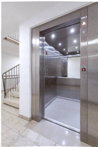
Tragfähiger Kompromiss: Neu ist einer von drei Liften behindertengerecht.
