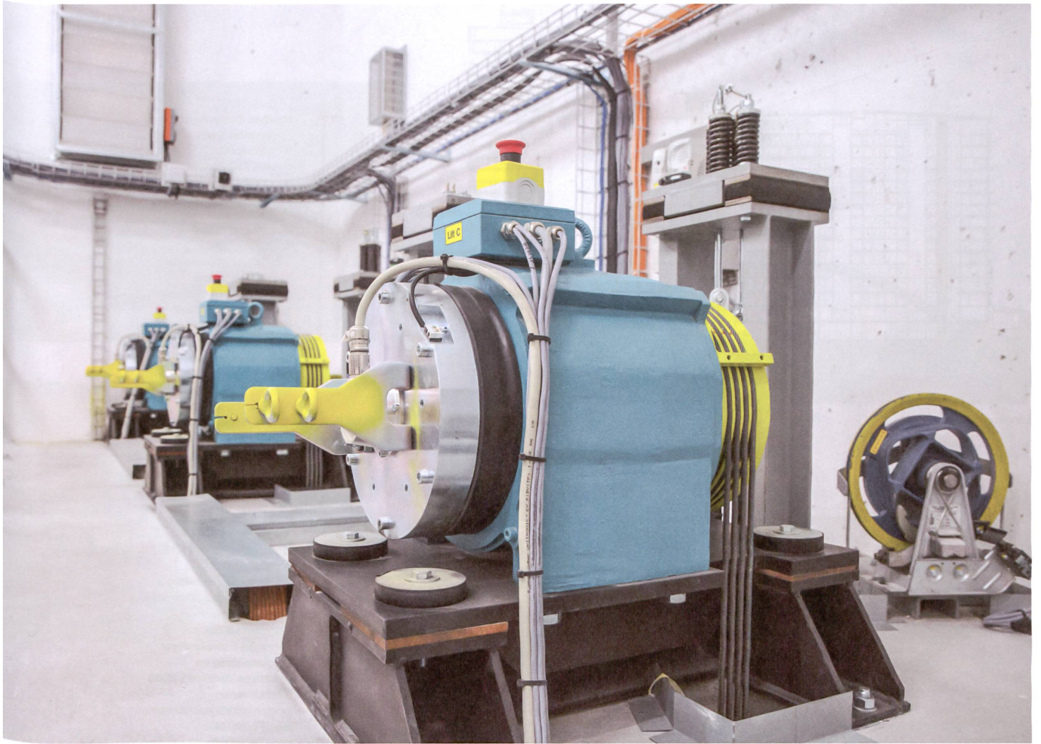
Das Optimum, nicht das Maximum an energiesparender Technik: In diesem Maschinenraum wird die beim Bremsen anfallende Energie nicht zurückgespeist.
