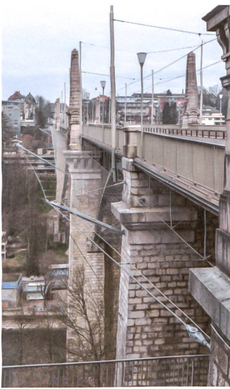
An der Kornhausbrücke ist das Netz knapp unter der Brückenplatte gespannt.
