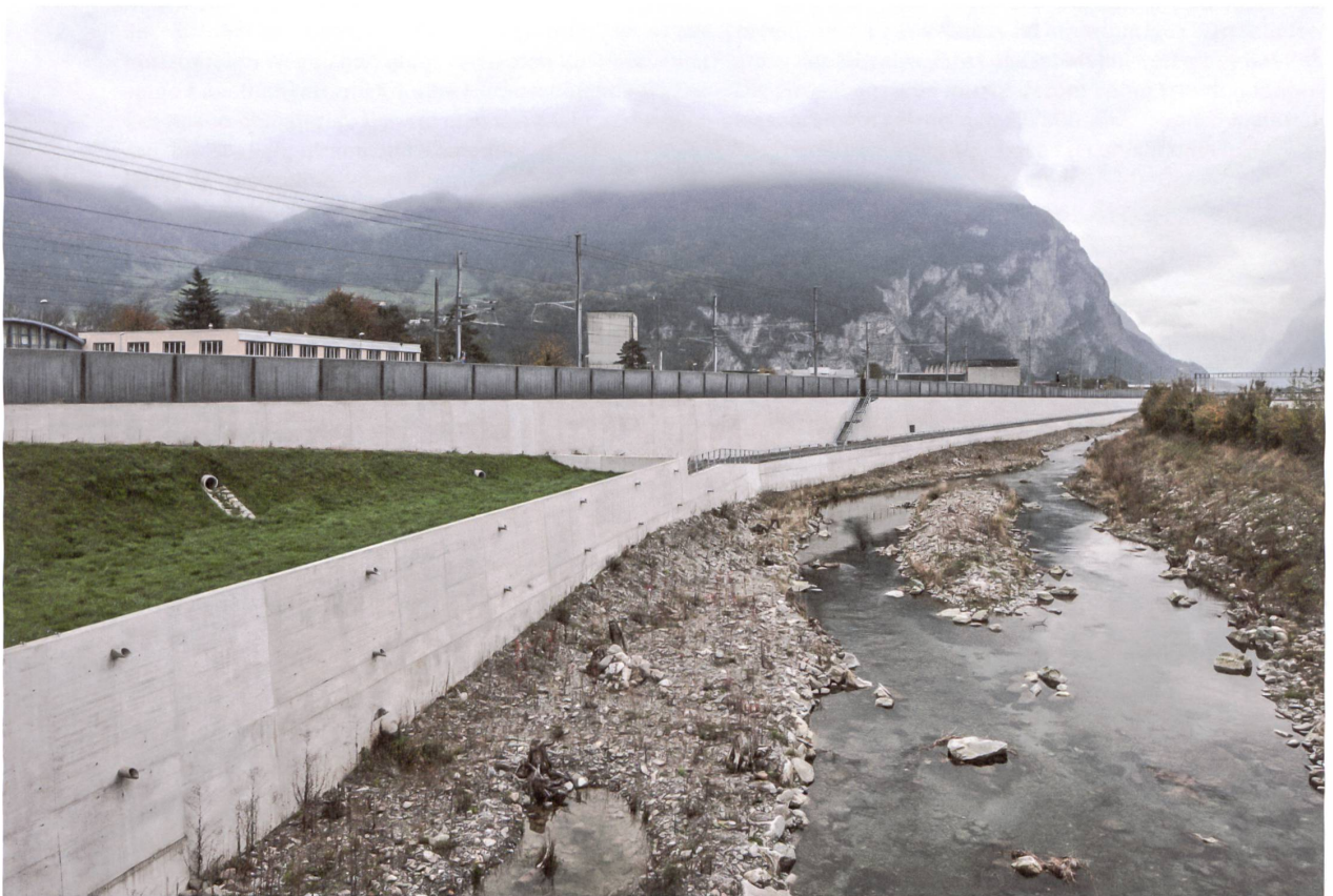
Entlang der Bahnlinie schützen Kunstbauten vor Hochwasser, wenn die Stille Reuss im renaturierten Flussbett bedrohlich anschwillt.
