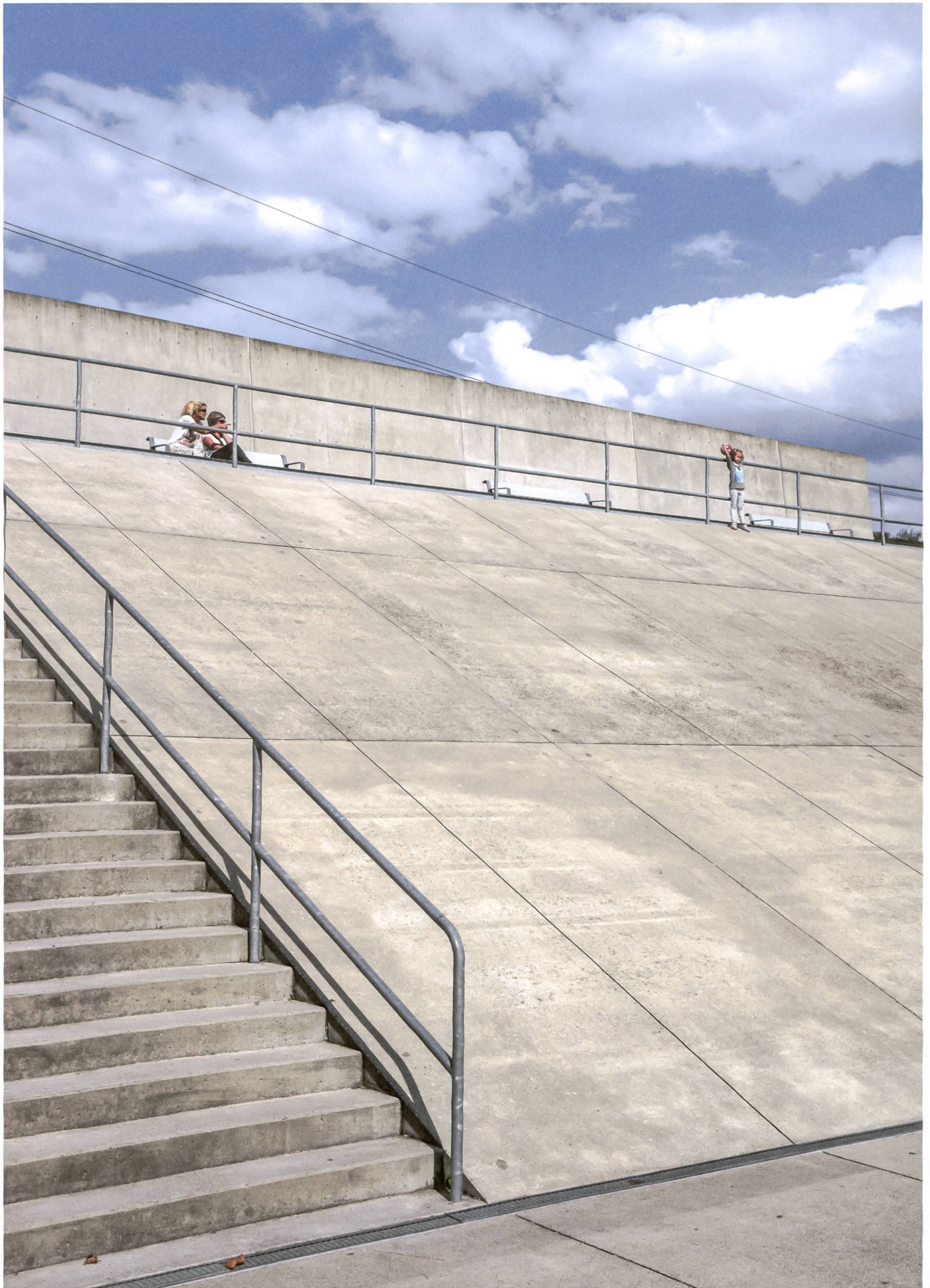
Die Rampe am Nordrand des Parks ist auch Aussichtsplattform: Sie besteht aus dem Aushub des Sees und schützt gleichzeitig vor dem Autobahnlärm.
