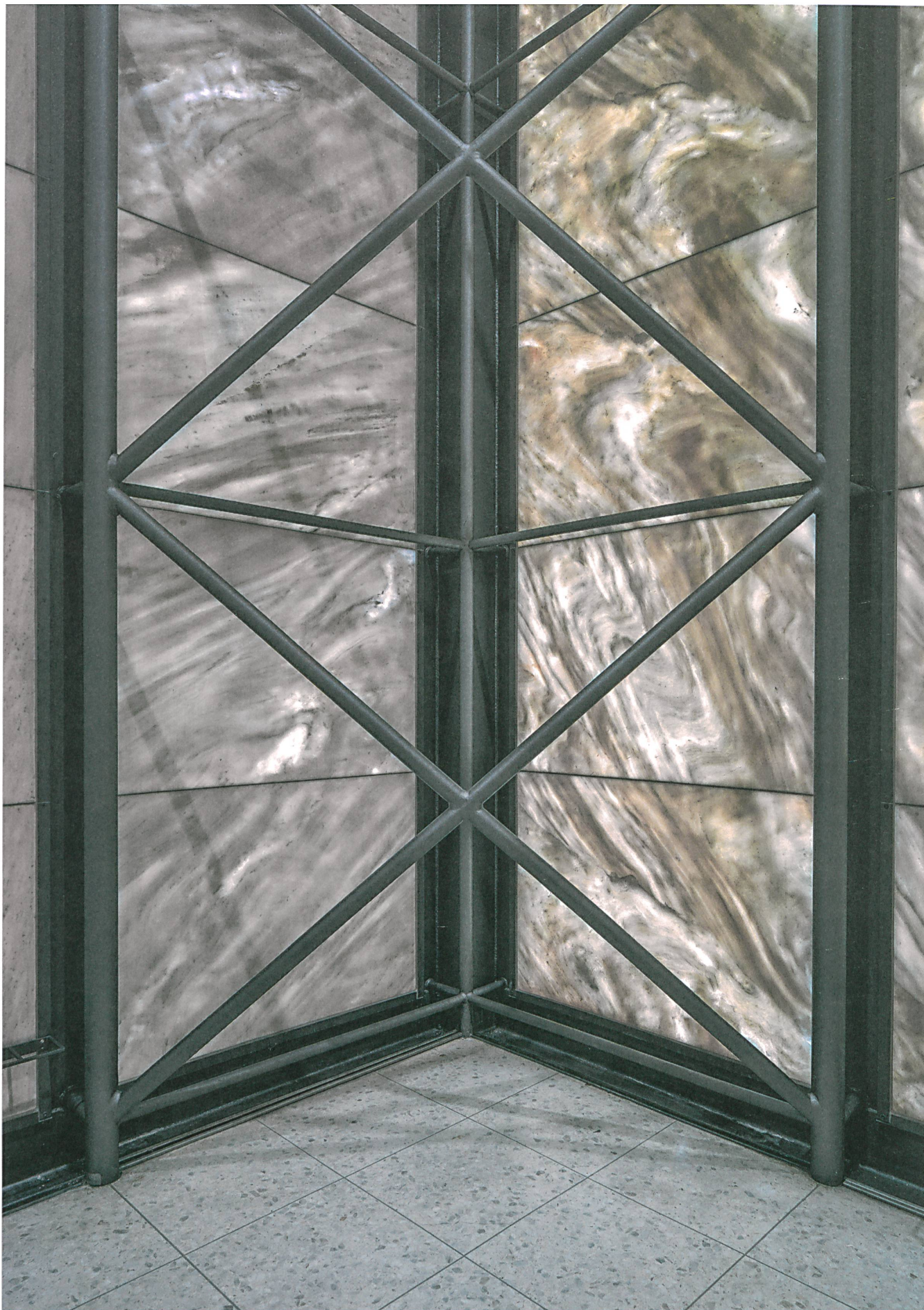
Die Fassade aus drei Zentimeter dünnen Marmorplatten wirkt bei der Piuskirche in Meggen als atmosphärischer Lichtfilter.
