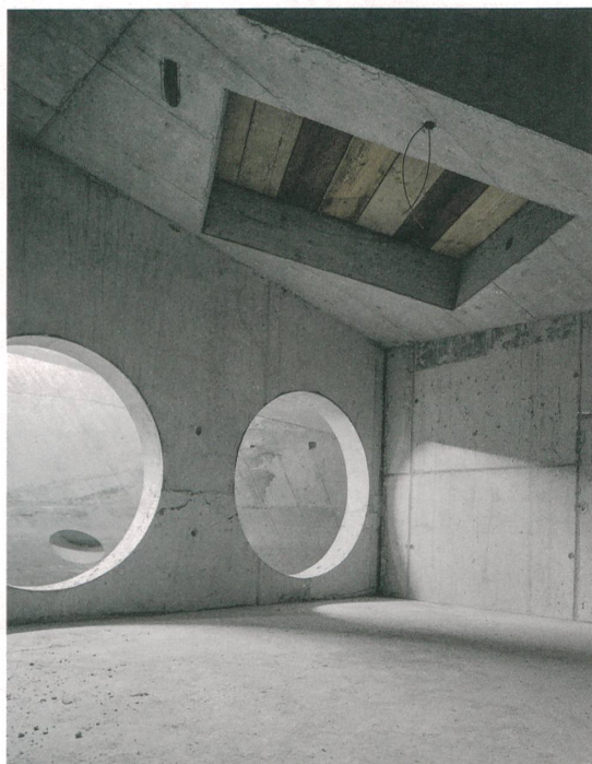
Keine Bullaugenfenster, sondern Löcher für die Rauchgasventilatoren. Im Dach klappt eine temporäre Öffnung. Durch sie werden die Schalungen nach Abschluss des Rohbaus aus dem Gebäude transportiert.
