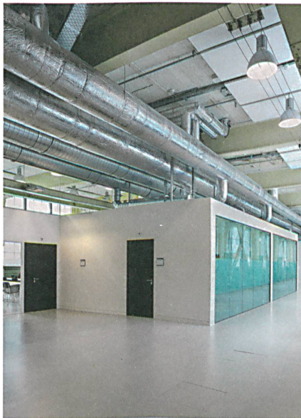
Im ersten Obergeschoss ducken sich Gruppenräume und Hörsäle unter die gewaltigen Haustechnikanlagen.
