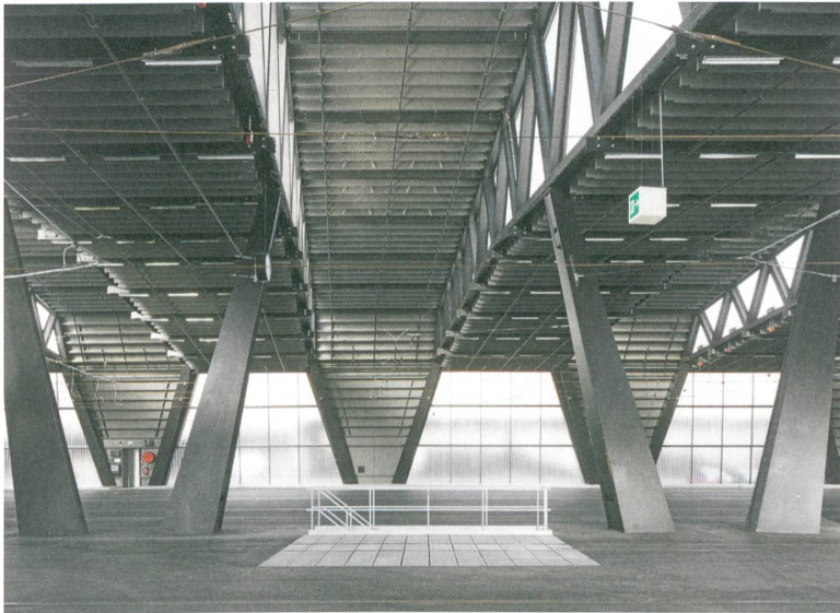
Verglaste Seitenwände und Stahlfachwerkträger an der Decke lassen so viel Sonnenenergie ins Haus, dass im Winter nicht geheizt werden muss.
