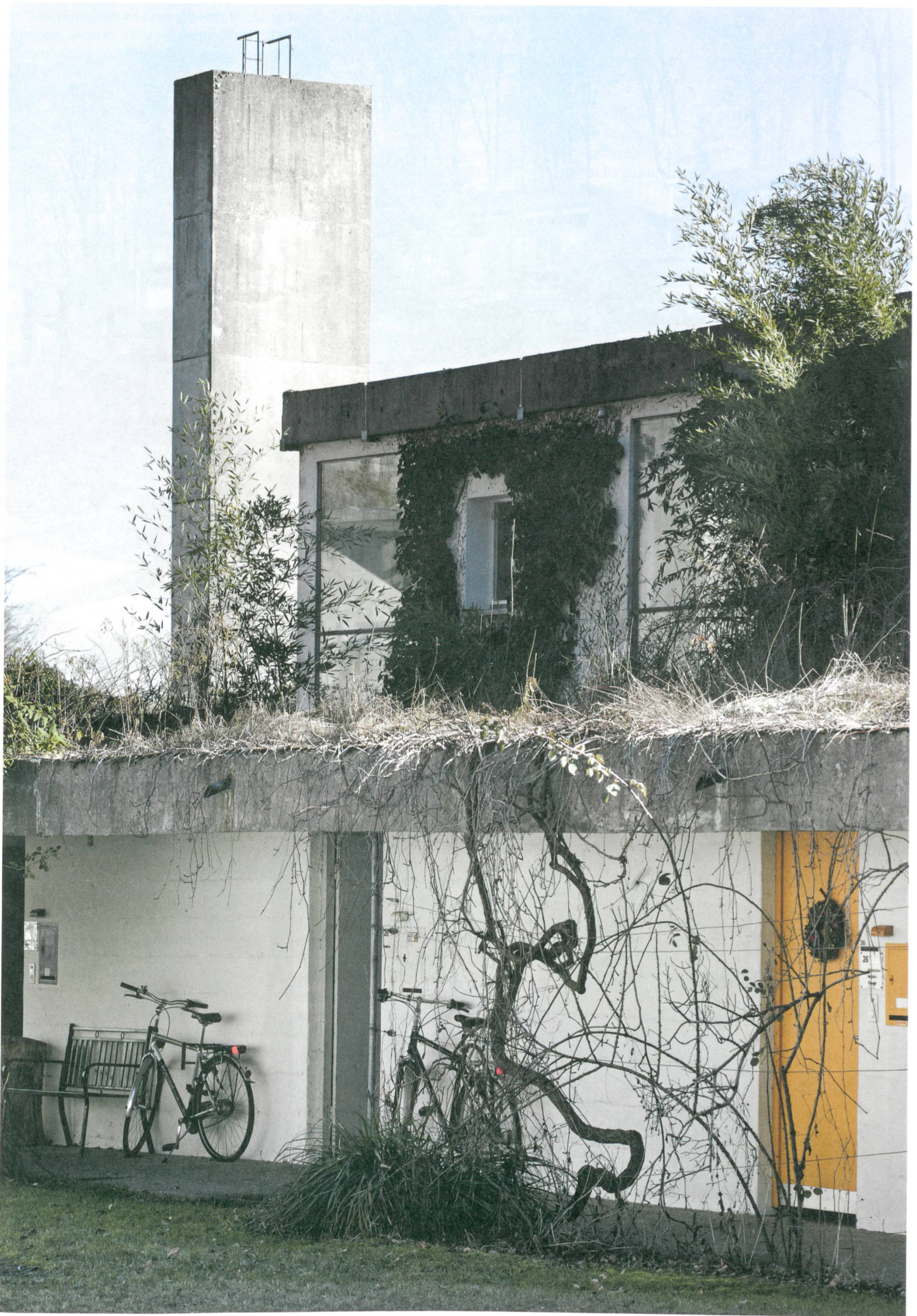
Halen-Reihenhäuser in Herrenschwanden in der Gemeinde Kirchlindach bei Bern: Hinter überwucherten Wänden bröckelt nach gut fünfzig Jahren der Beton.
