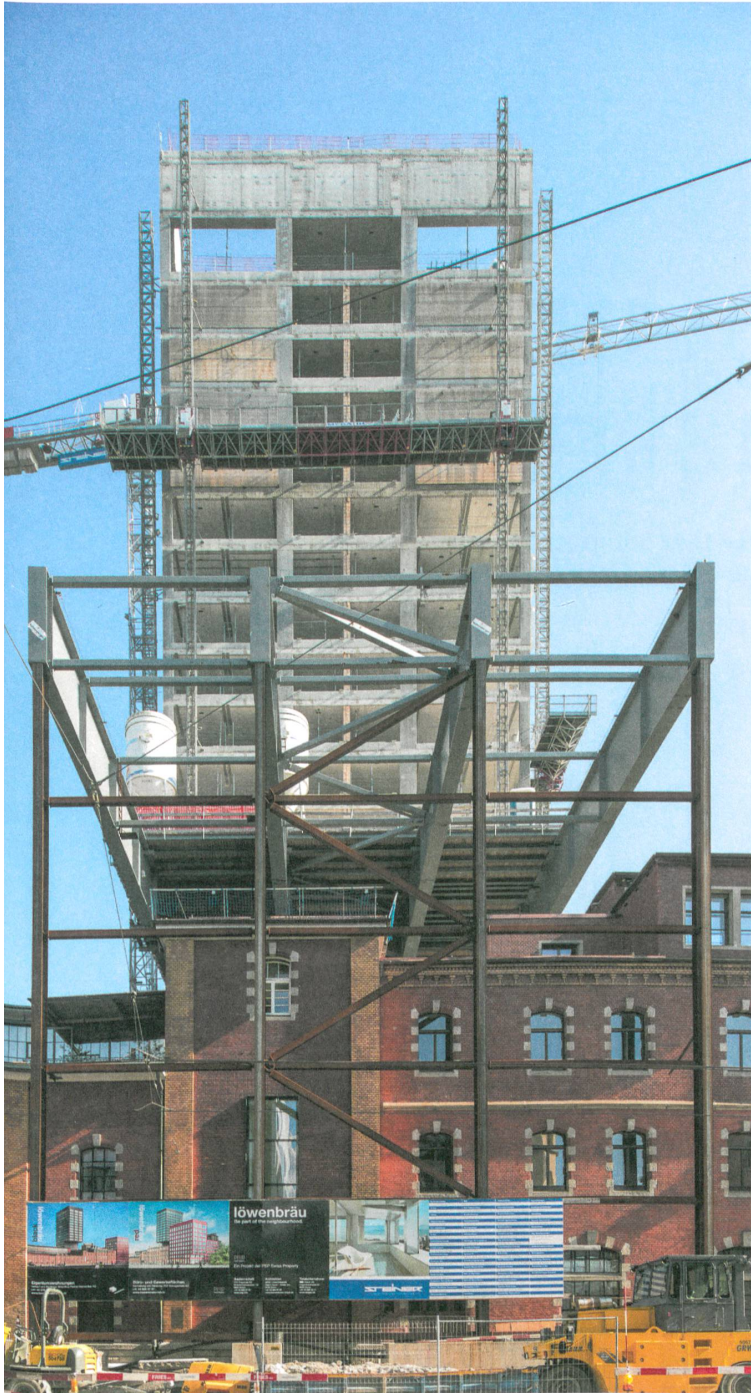
Während der Bauphase fing ein Stahlgerüst die Auskragung über dem Altbau ab. Foto: Thomas Zwysyig
