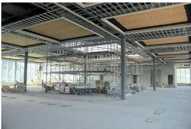
Im Kommandoraum sorgen Vollverglasung und Oberlicht für viel Tageslicht. Foto: SBB
