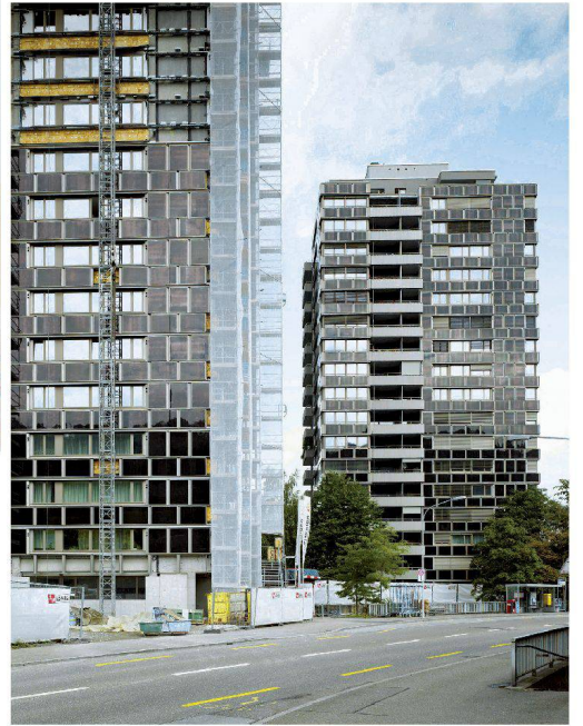
^Die Fotovoltaikfassade zeigt die neue Energieeffizienz.
