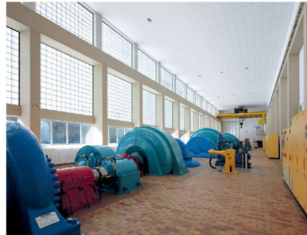
^EWZ-Kraftwerk Löbbia. ^Centrale elettrica EWZ di Löbbia.
