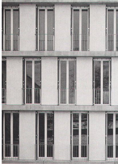
Die fortlaufenden Reihen der tragenden Wandplatten sind von Geschoss zu Geschoss gegeneinander versetzt
