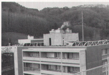
Solaranlage zur Warmwasservorwärmung
