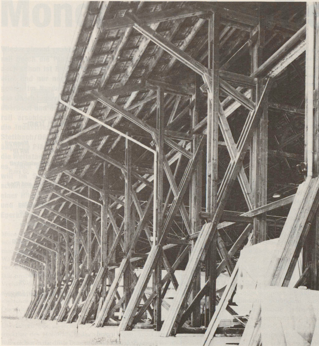
Eine reife Bauingenieurleistung von hoher Qualität: Die Bretterhalle von Lachen, längsseitiger Blick auf die Konstruktion.
