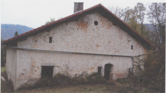
Figure 21 17-07 Cette ancienne ferme est squattée par des blaireaux. Ils ont creusé leurs terriers à l'intérieur de l'écurie. (Photo N. Gogniat, 2015)
