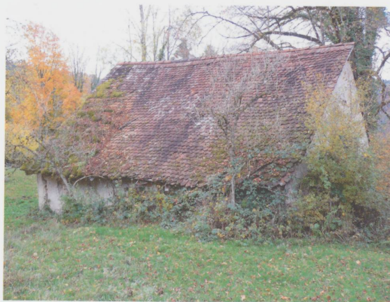
Figure 1 5-02 Magnifique loge dans les Côtes du Doubs. Sans chemin d'accès, isolée, elle menace ruine. (Photo N. Gogniat, 2015)
