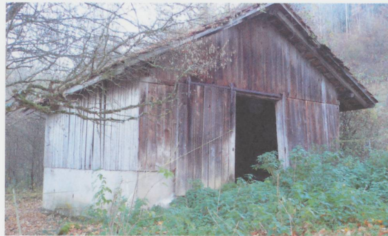
Figure 5 7-01 Belfond, le montant droit est déboîté de la sablière, c'est de mauvais augure ! (Photo N. Gogniat, 2015)
