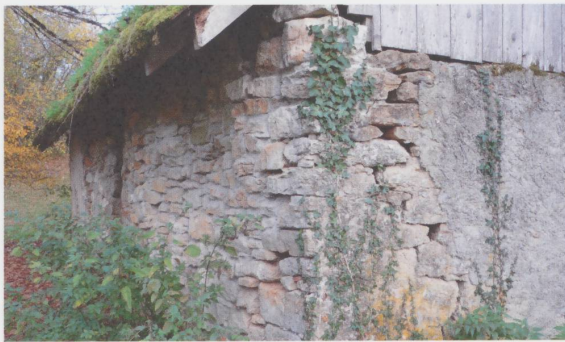
Figure 45 5-02 Loge en mauvais état. (Photo N. Gogniat, 2015)
