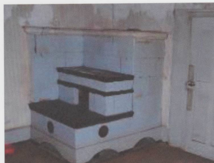
Figure 12 Le kuntch d'origine, malheureusement défectueux. (Photographie Thierry Boillat, 2013)
