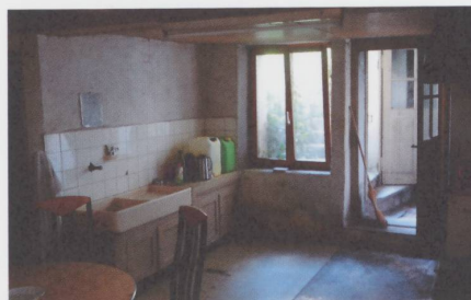
Figure 8 État de la cuisine avant rénovation. Au-dessus de l'évier on aperçoit l'unique robinet d'eau froide. (Photographie Thierry Boillat, 2013)
