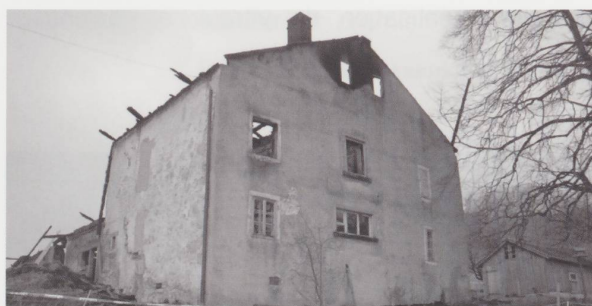
Figure 2 Photographie de la ferme prise après l'incendie. (Photo Luc Bron, 2011)
