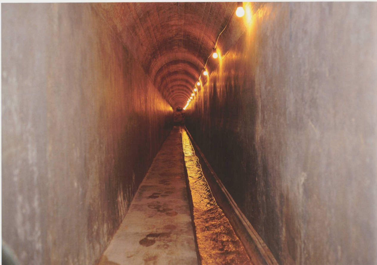
Galerie située entre le captage de l'Ante et la chambre de distribution.
