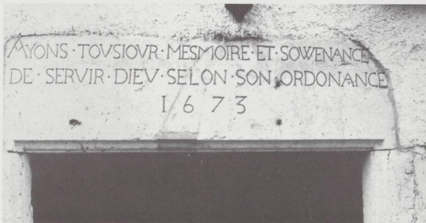
Boinod (La Chaux-de-Fonds). Aux symboles chrétiens stéréotypés, le constructeur protestant préférerait l'une ou l'autre maxime pieuse. On en voit surtout sur les façades du XVIII e siècle.
