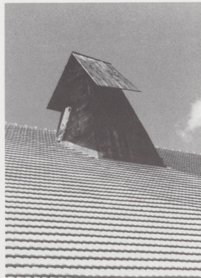
Le tronc de pyramide du «tué» de bois traverse le toit; son orifice est protégé des vents et des précipitations par un ou deux volets (Le Cerneux-Péquignot, NE). La pente n'excédant pas 30°, le risque de glissement est réduit, tant pour les bardeaux non cloués que pour les couvreurs.
