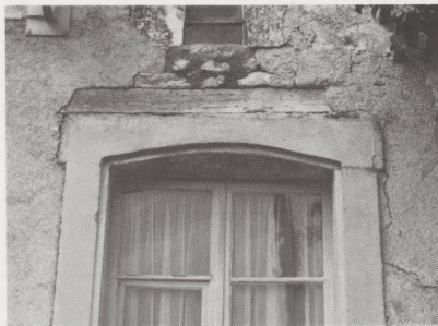
Pour éviter que les linteaux se brisent ... aux Cerneux Veusil
