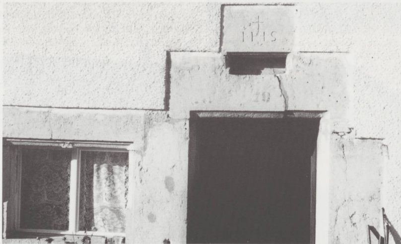
Les Peux. Le linteau s'est brisé en raison de la surcharge due à un manque d'attention lors de l'abattage de la voûte de la cuisine. Le meneau de la fenêtre manque. Malgré un bouchardage soigné, des traces de suie subsistent dans « l'évent ».
