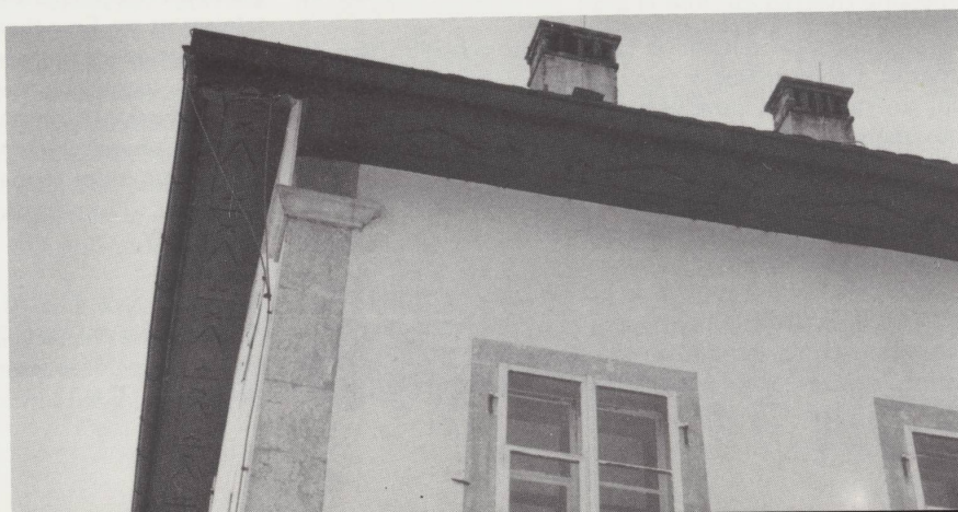
Sur-le-Crêt , XIX e siècle. Panneaux à losanges et étoiles lambrissant l'avant-toit. Photo 1978.
