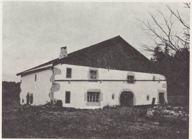
Daté de 1663, ce beau bâtiment est abîmé par les formes grossières de la taille laissée visible ! Les deux meneaux de la fenêtre du poêle et celui de la fenêtre de l'étage manquent.
