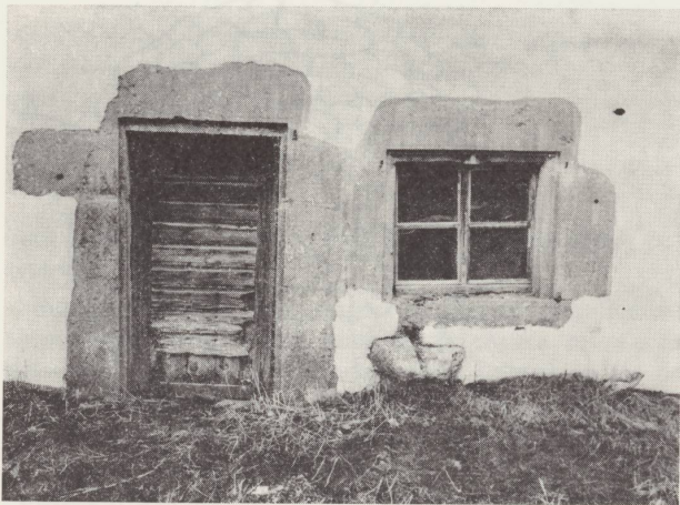
Le constructeur n'a pas voulu cela !
