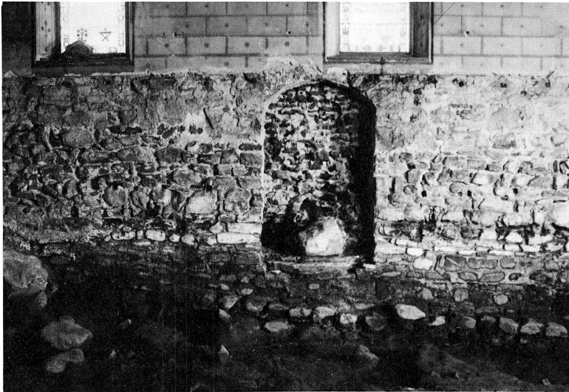
8 Nordmauer I: Die Grenze zwischen dem ursprünglichen Mauerwerk und einer späteren Neuaufmauerung liegt ungefähr auf der Höhe der horizontalen schwarzen Verfärbung (moderne Bitumeninjektion).
