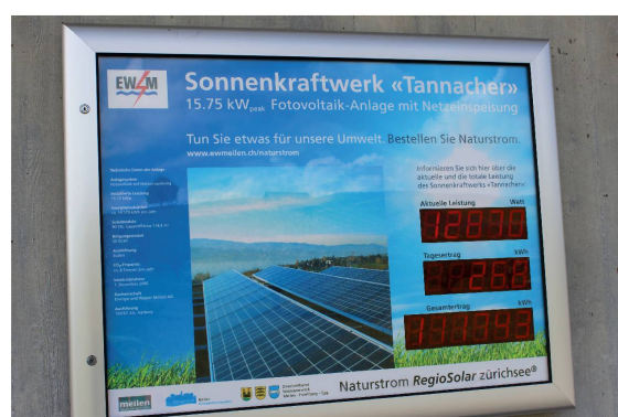
Messstation des Sonnenkraftwerks auf dem Reservoir Tannacher.
