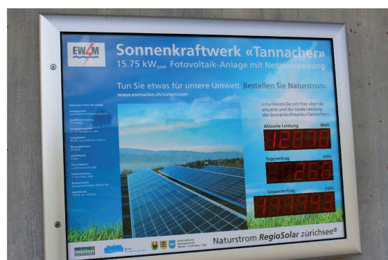
Messstation des Sonnenkraftwerks auf dem Reservoir Tannacher.
