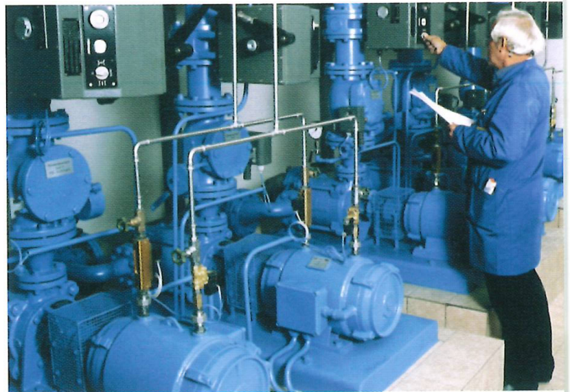
Oben: Wasserversorgung Stadt Zürich, Pumpwerk Frauental Unten: Hochdruckpumpanlage Wasserversorgung Aegeri
